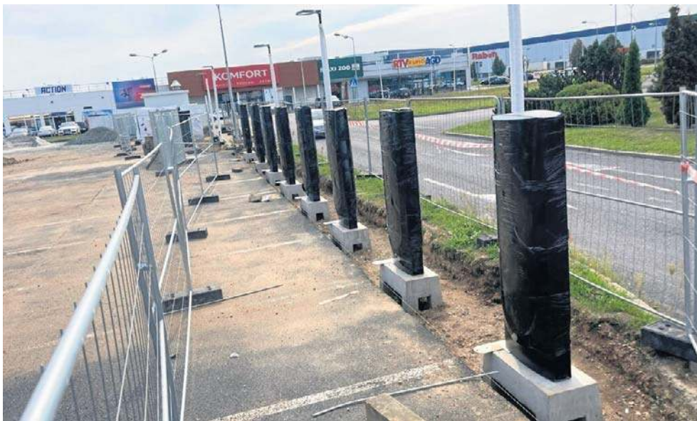
Na placu stoi już dwanaście nowoczesnych ładowarek
