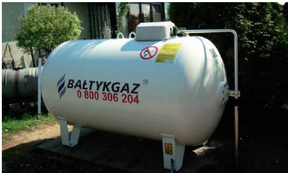
🔥 Gaz płynny (propan) ma podobne właściwości co gaz ziemny z sieci. Do jego spalania używa się tych samych kotłów. BAŁTYK GAZ
