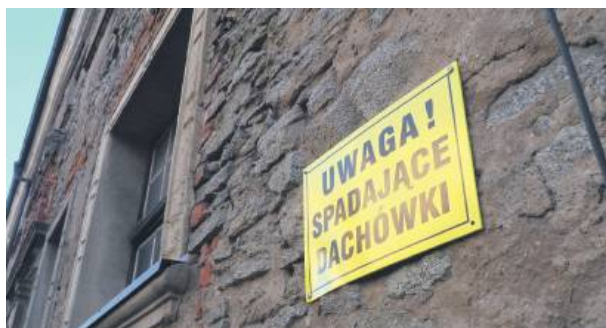
Najczęściej podczas wichur z budynku leżą dachówki
