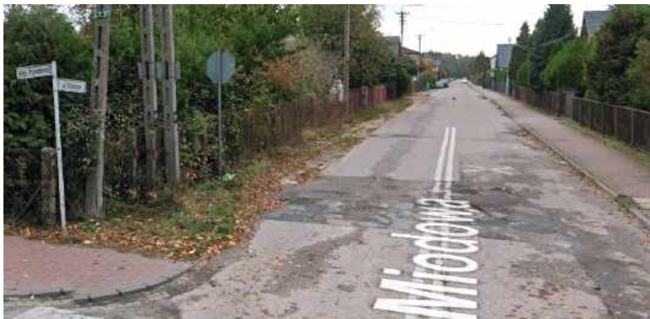
Widok na ulicę Miodową z Google Maps. Remont się przyda
