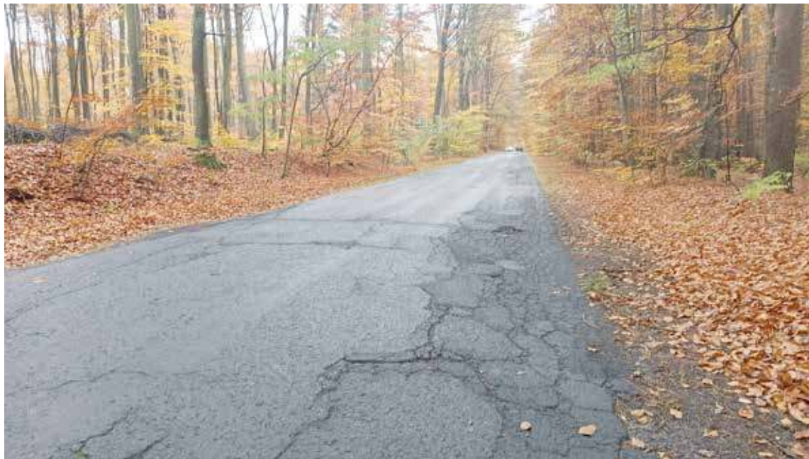
Droga pomiędzy Goleniowem a Bolechowem rozpaczliwie potrzebuje remontu
