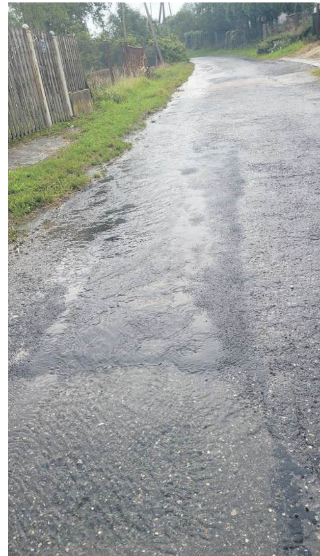
Ulica św. Krzyża nawet po niedużym deszczu zamienia się w rzekę
