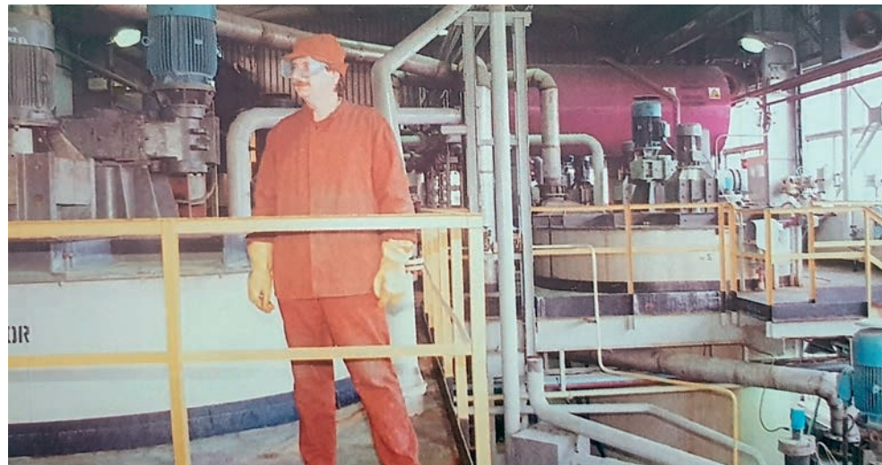
Instalacja odmagnezowania w ZG Trzebinia S.A. w Trzebinii w latach 90. fot. z folderu prezentującego zakład z lat 90.
