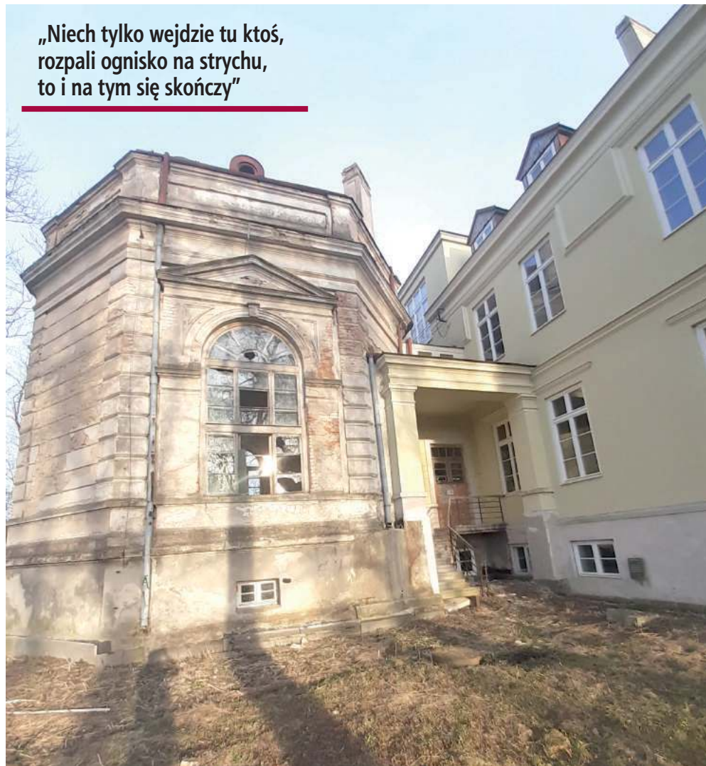
Jedna czwarta elewacji budynku nie została odnowiona z powodu utraty dofinansowania
