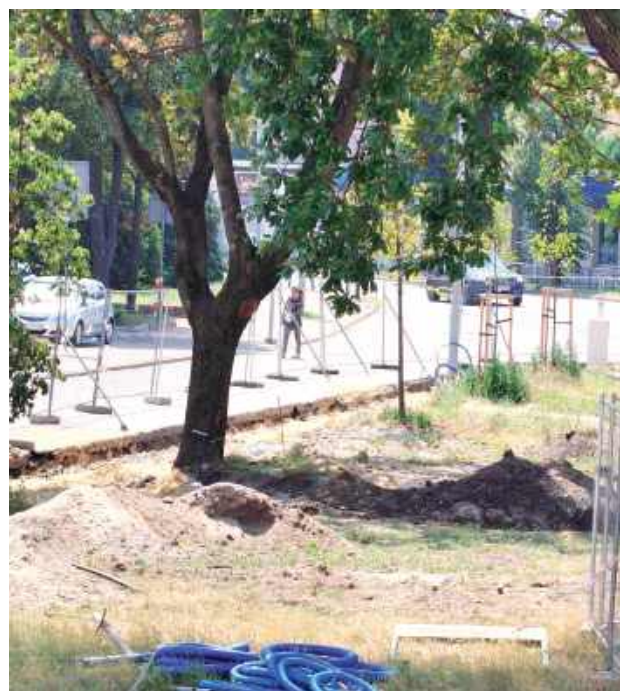
Drzewa rosnące na terenie przebudowywanego placu Narutowicza mają zbyt sucho
