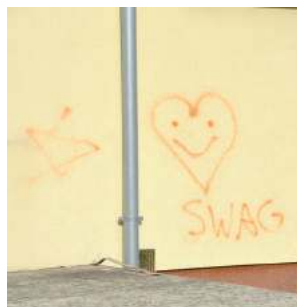
Zniszczona elewacja budynku remizy OSP w Łaziskach
