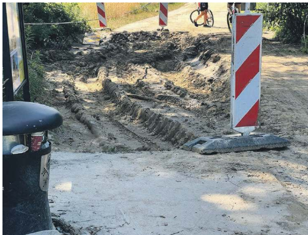
Tego fragmentu ścieżki rowerowej na granicy gminy w okolicach Brzykowa, w ogóle nie zrobiono, ale gmina za niego zapłaciła. Czy teraz zapłaci drugi raz, ale komuś innemu?
