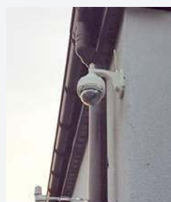
📹 Kamera zewnętrzna na ścianie budynku.
