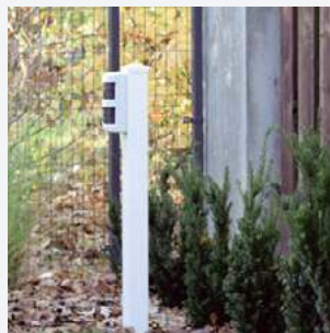
☛ Słupki z zewnętrznymi czujnikami ruchu.
