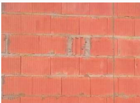
❷ Pustaki wmurowane w niewłaściwym kierunku osłabiają izolacyjność cieplną i akustyczną ściany oraz jej wytrzymałość na ściskanie. T. RYBARCZYK
