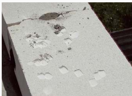
❗ Złe użycie narzędzi. Młotek murarski uszkodził powierzchnię bloczków z betonu komórkowego. T. RYBARCZYK
