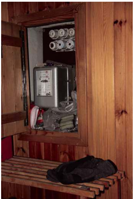
🔧 Stare rozdzielnice przy modernizacji trzeba wymienić. J. WERNER
