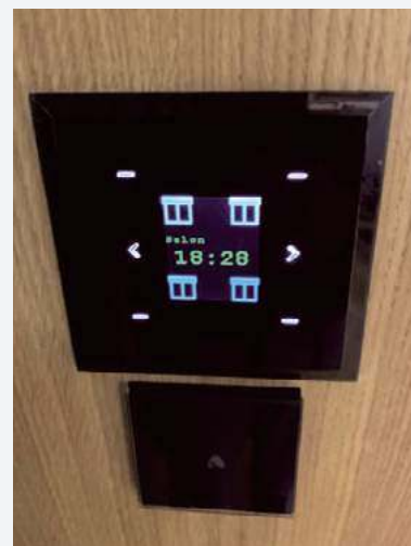
📱 Panel dotykowy na ścianie.
