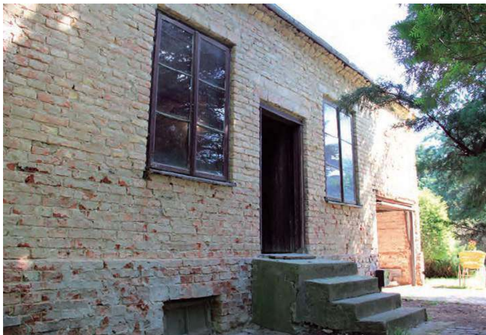
❶ Odspojone i mocno zagrzybione tradycyjne wyprawy tynkarskie trzeba skuć. J. WERNER
