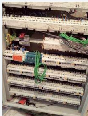
❶ Szafa rozdzielcza do przewodowego otwartego systemu inteligentnego KNX.
