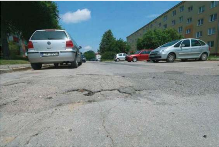
Ulica Witosa od lat czeka na przebudowę
