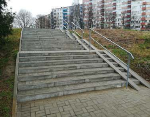
Brak poręczy przy tak stromych schodach był, zwłaszcza dla seniorów, dużym utrudnieniem
