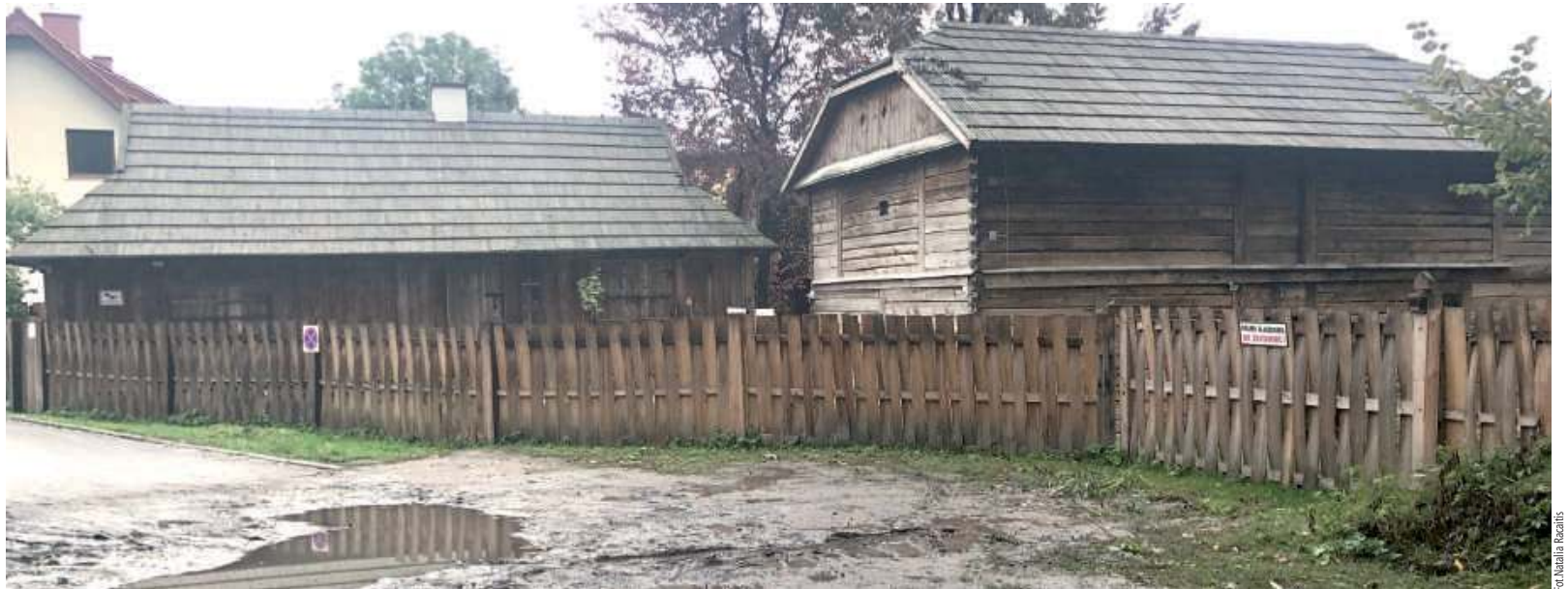
Nowym sztachetowy pleciony płot dranczasty ogradzający muzealne obiekty na ulicy Czerwonego Krzyża został uszkodzony przez wandalę w niecałe dwa miesiące od otwarcia spichlerza dla zwiedzających
