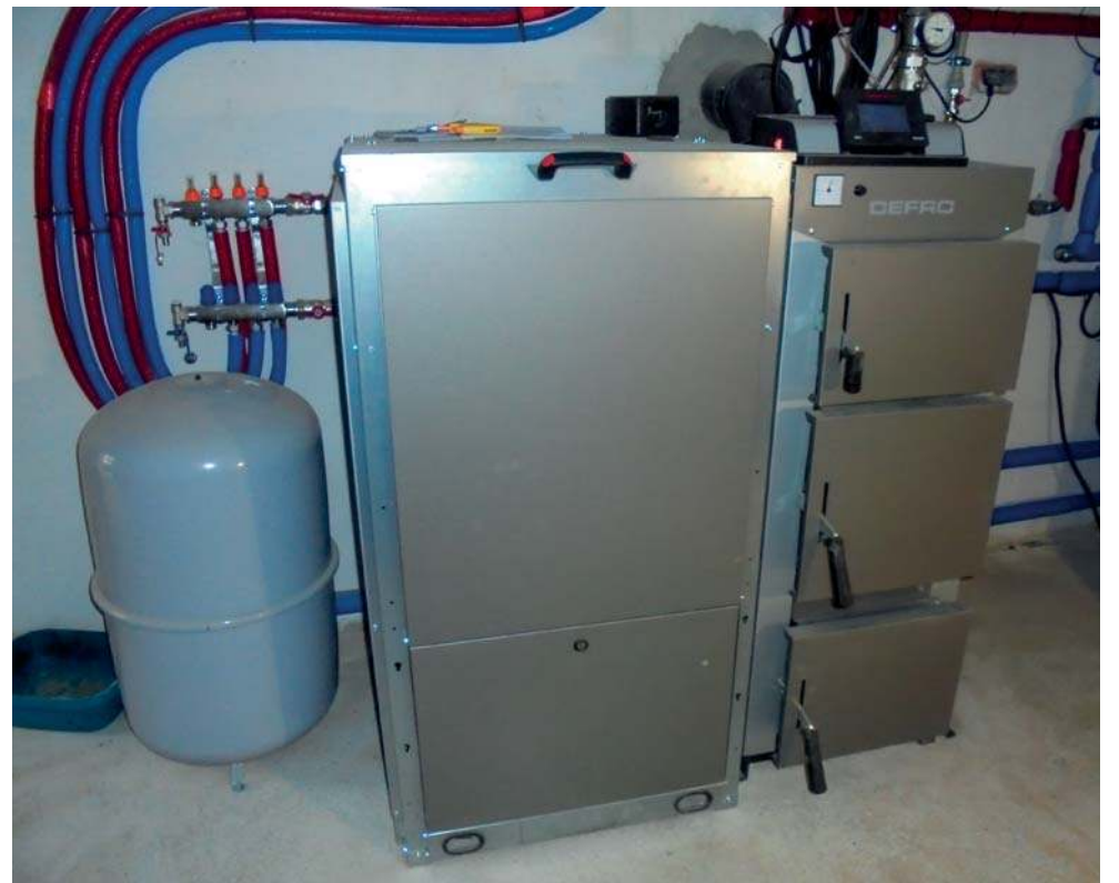
Kotłownia na pellet dofinansowana z Programu Czyste Powietrze
