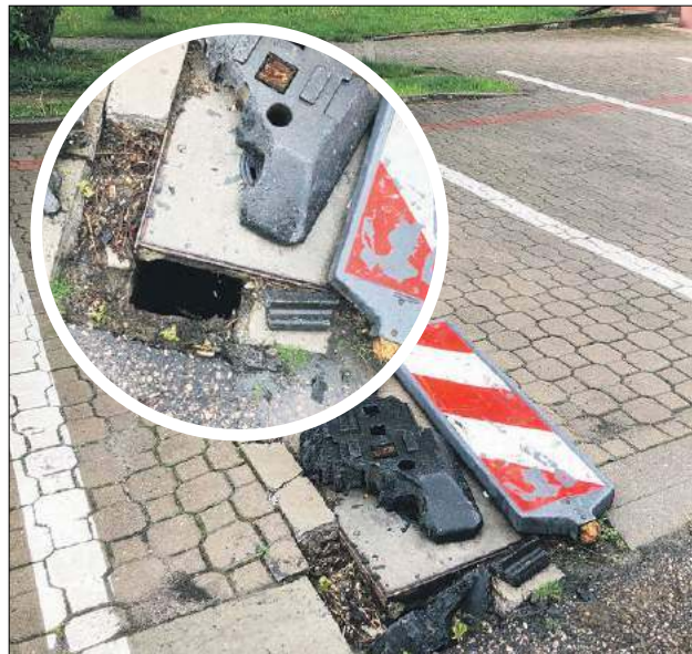
Mieszkaniec Radzyna Podlaskiego interweniował w sprawie dziury w drodze. Uszkodzenie w jezdni naprawiono po sygnale redakcji
