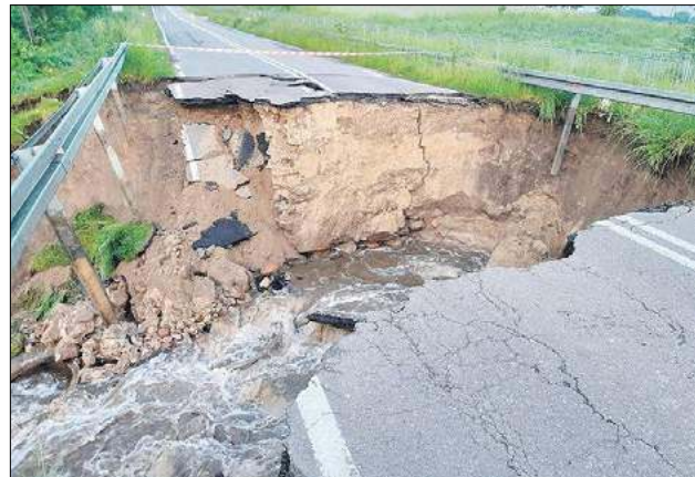
W okolicach miejscowości Kuzawka rzeka Bug podmyła jezdnię drogi wojewódzkiej nr 816 tzw. „Nadbużanki”. Na drodze powstała ogromna dziura, a trasa jest nieprzejezdna
