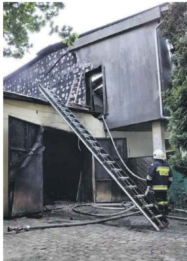
Ogień przemieścił się do remontowanego mieszkania
