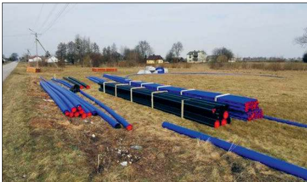
Łączna długość sieci grawitacyjnej i ciśnieniowej wynosi 6,98 km. Do sieci kanalizacyjnej zostaną przyłączone 93 gospodarstwa domowe
