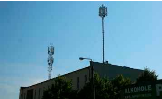
Kolejne nadajniki i anteny telefonii komórkowej stawiane na dachach budynków na os. Ruta niepokoją mieszkańców
