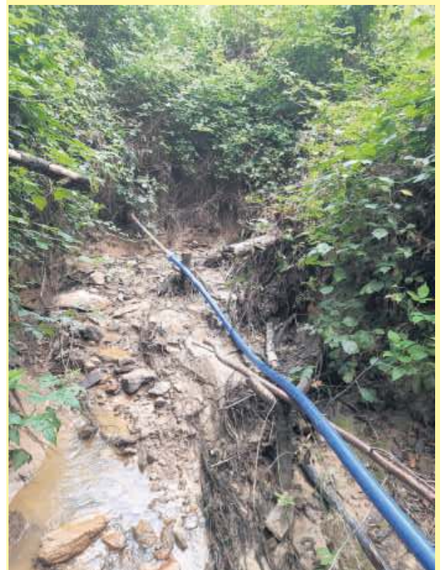
Rurociąg doprowadzający wodę do kilku domów w Miłoticach przebiega przez wawóz
