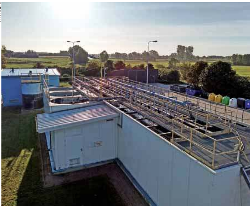
Część technologiczna oczyszczalni
