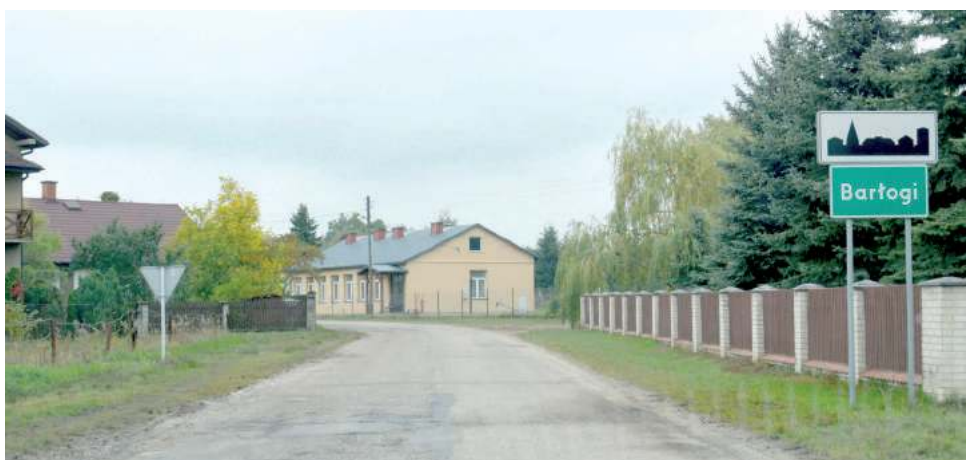
Dziś stan drogi w Barłogach nie jest najlepszy. Szosa ma liczne ubytki. Wizerunek drogi ma odmienić remont, który zakończy się do lipca 2020 roku. Przebudowanych zostanie 670 metrów drogi
