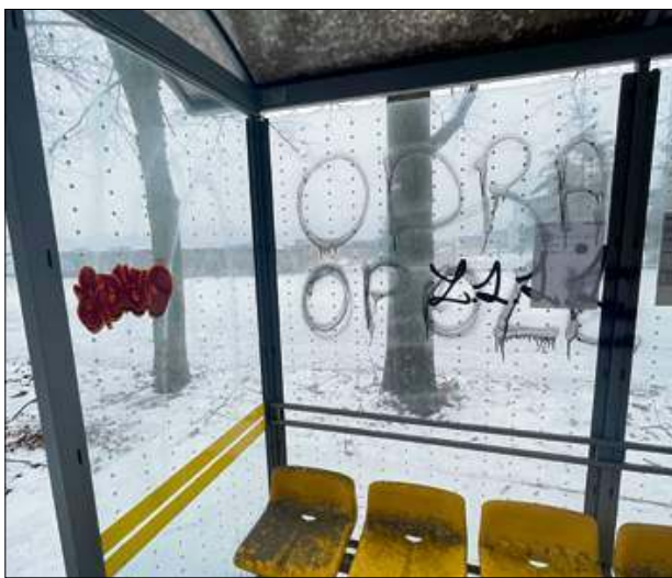
Przystanek przy ulicy 3 Maja w Otmęcie został zniszczony przez wandalę.
