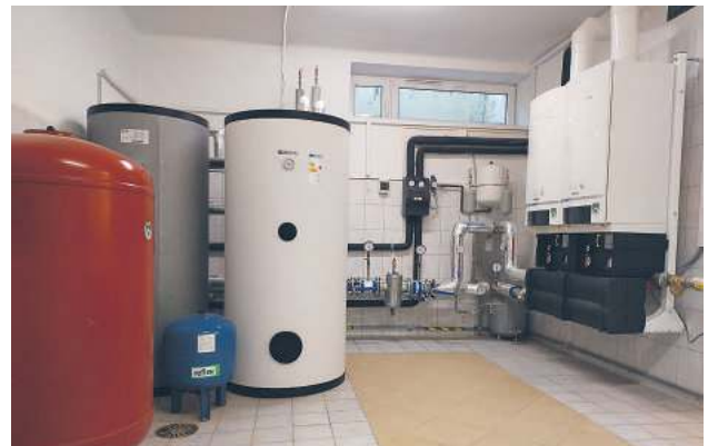
Nowa kotłownia w Domu Dziecka w Krasnymstawie
