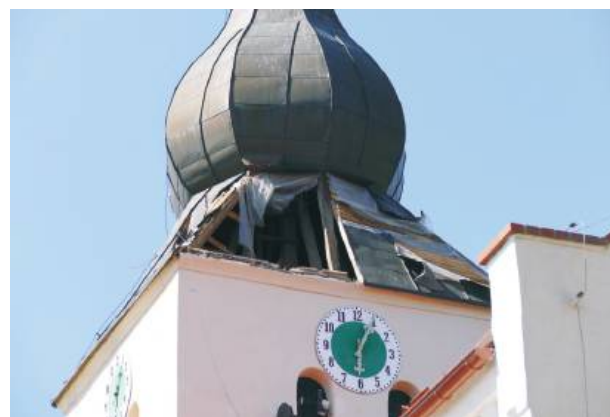
W Witowicach nawałnica zniszczyła kopułę wieży kościelnej
