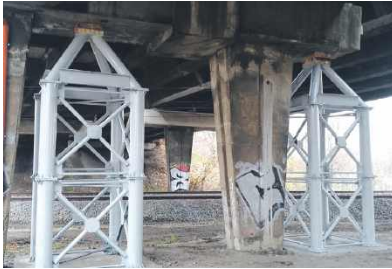
Podpory to jedynie rozwiązanie tymczasowe
