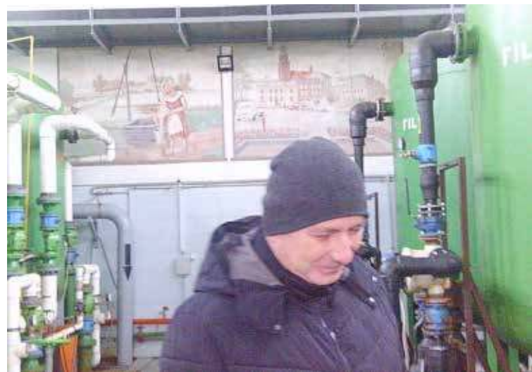
Wnętrze pomieszczenia z filtrami i pompami
