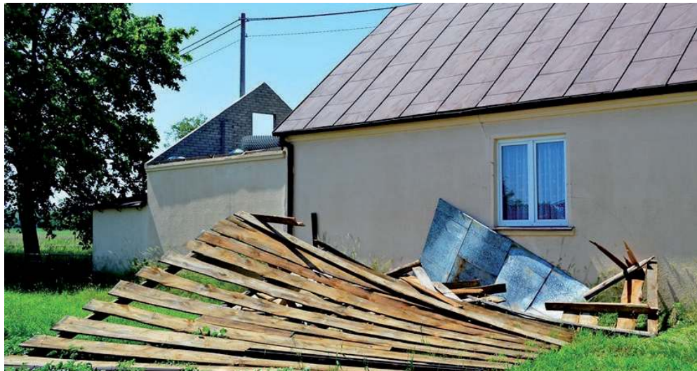
Burza zerwała dach OSP w Wólce Krzymowskiej (gmina Międzyrzec Podlaski)
