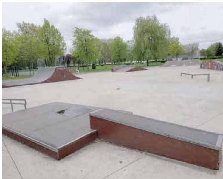
W przynajmniej trzech elementach skateparku można znaleźć mniejsze bądź większe ubytki w nawierzchni
