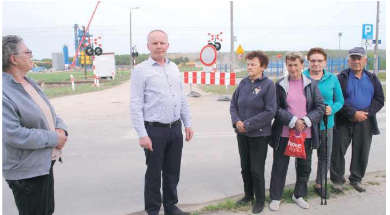
Mieszkańcy Wandzina mieli do starego przystanku około 300 metrów. Teraz jest zakaz wstępu, bo trwa budowa ekspresówki. Drugi z lewej sołtys i radny Ireneusz Szczuchniak
