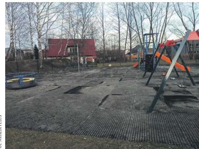
Plac zabaw przy ul. Ogrodowej na os. Siersza w Trzebini - nowy, a już zniszczony
