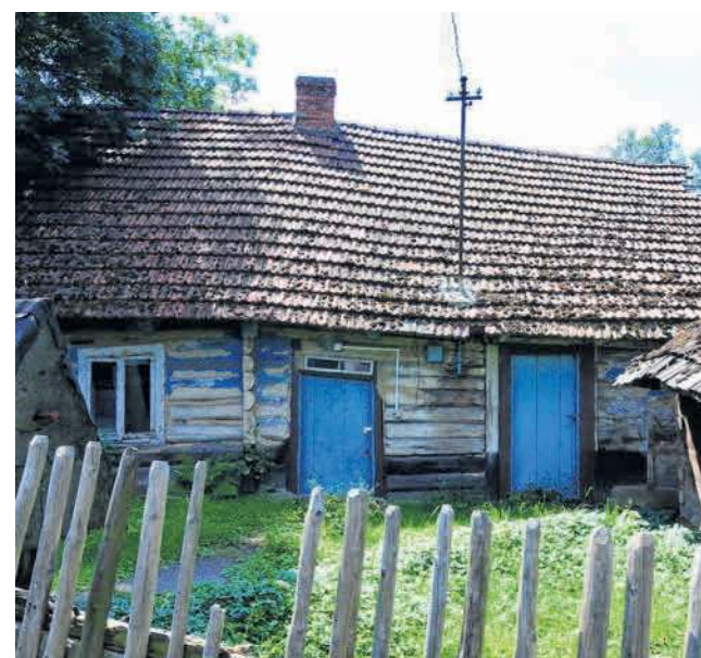
To jedna z urokliwych - ale w fatalnym stanie technicznym - chałup w Mogile (część Nowej Huty)
