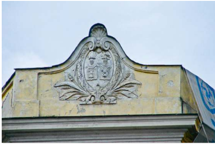
Niszcząca kamienica przy ul. Zgoda 1 (z prawej) i zwieńczenie jej narożnika
