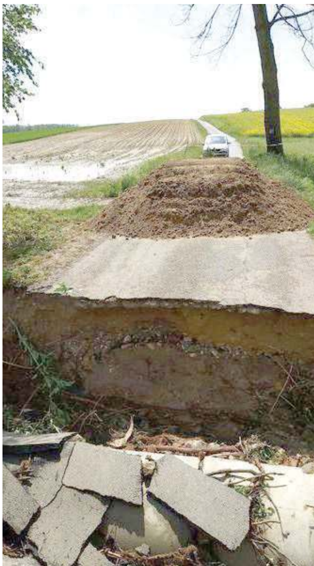
W tym momencie droga na samej granicy gmin Markuszów i Garbów jest nieprzejezdna – oba samorządy prawdopodobnie wspólnie zajmą się naprawą
