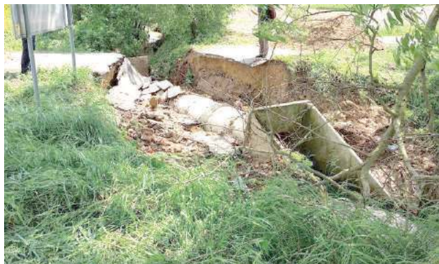
Strumień przepływający pod drogą po obfitych deszczach zmienił się w potok. Tego nie wytrzymał przepust, a droga się zawałiła
