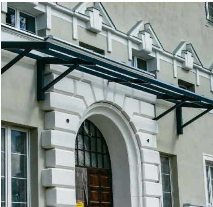
Wejście główne do gmachu dawnej Wolnej Wszechnicy Polskiej przy ul. Banacha 2 oszpecone konstrukcją zadaszenia | fot. Janusz Sujeci/Gazeta Polska
