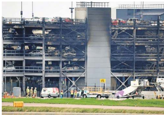
W efekcie pożaru zniszczonych lub uszkodzonych zostało ok. 1200 samochodów na lotniskowym parkingu
