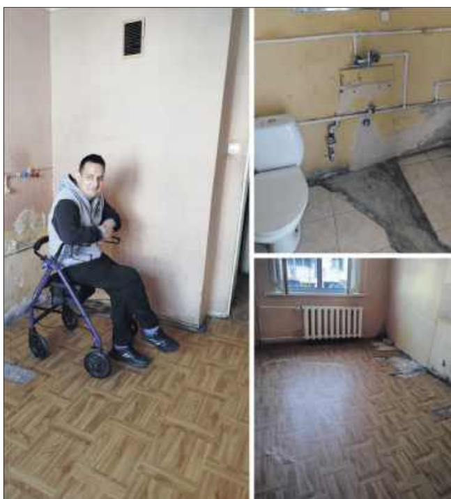
■ Mieszkanie przy Kokoszyckiej wymaga gruntownego remontu
