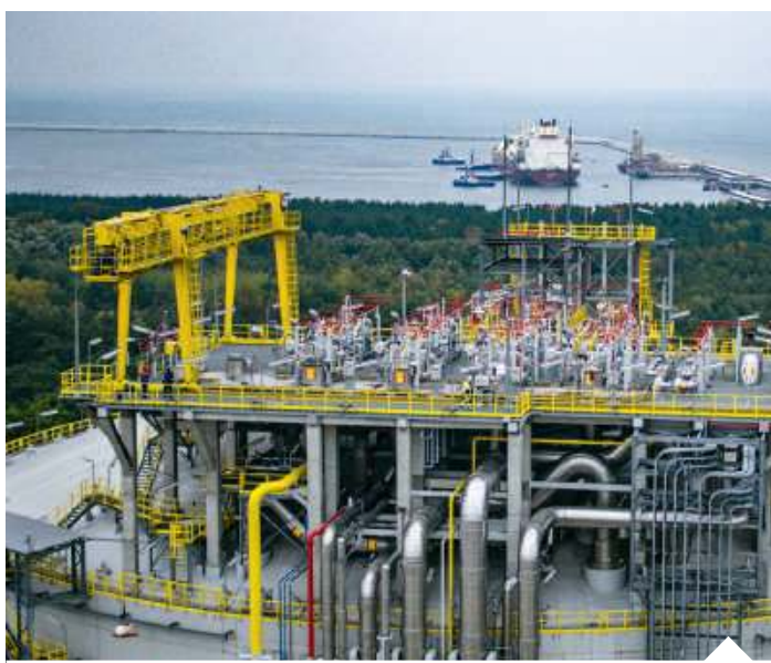
Terminal LNG w Świnoujściu. Takiej infrastruktury nie mają Niemcy | fot. Gaz-System /d
