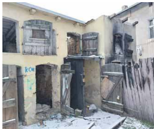
Także budynek gospodarczy jest po pożarze
