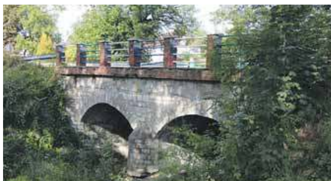
Stary most jest w złym stanie technicznym. Wkrótce zostanie wyburzony
