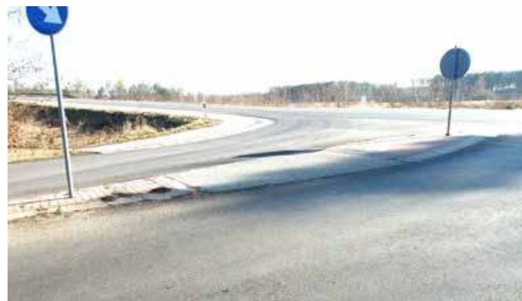
Na przejściu nie ma pasów ani innych znaków
