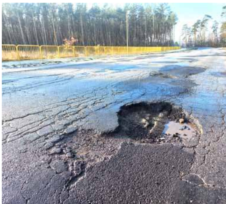
Ubytki w nawierzchni są znaczne.
