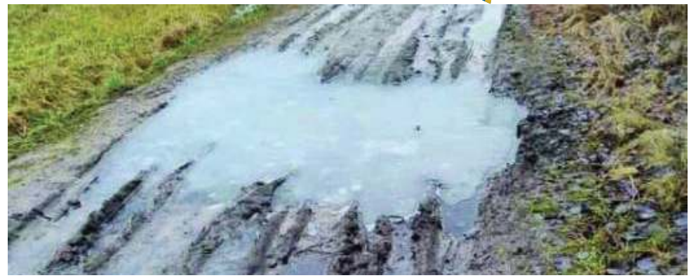
To zdjęcie drogi z lutego tego roku. Kolejne pokazują jej stan po ostatniej burzy
