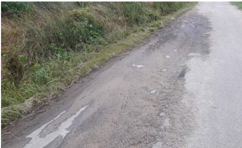
Ta ciemna plama, to błoto i ślad po wodzie, która zalała drogę
