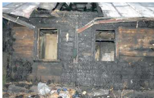
Pożar poważnie zniszczył dom. W zgłiszczach znaleziono ciało 85-letniej właścicielki. Kobieta mieszkała sama
