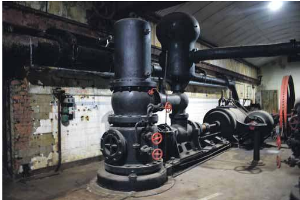
A to prawdziwy rarytas. Maszyna parowa w podziemiach szybu Staszic. Wygląda tak, jakby w każdej chwili można ją było uruchomić i „zaprząć” do pomp
