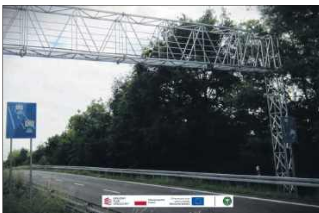
■ Kierowcy jadący DK81 powinni zwracać uwagę nie tylko na znaki ustawione przed odcinkiem pomiarowym, ale przede wszystkim utrzymywać właściwą prędkość przez całą trasę między Ochabami Małymi a Skoczowem. FOT. FB CENTRUM AUTOMATYCZNEGO NADZORU NAD RUCHEM DROGOWYM
