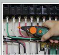
bezprzewodowa detekcja napięcia
