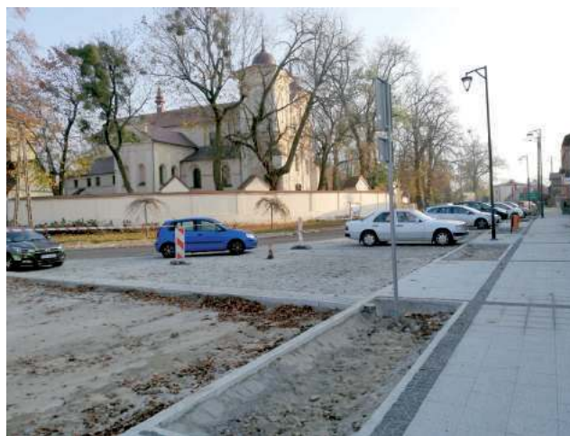
Odbioru jak nie było tak nie ma. Inspektor nadzoru ma nadal zastrzeżenia do wykonanych przez firmę Dura prac
