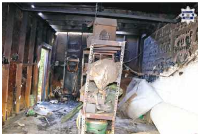
■ Pożar w garażu wybuchł wieczorem
