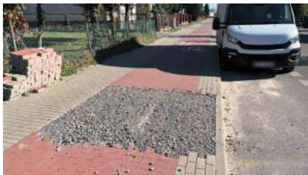
- Od ponad miesiąca miasto zrobiło coś takiego. Rozkopali, zasypali to kamieniami i tak zostawili - pokazuje mieszkaniec Biłgoraja
