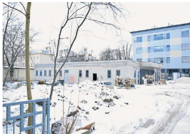
Dźwig żuraw zniknął już z placu budowy, wciąż jednak jest jeszcze sporo do zrobienia
